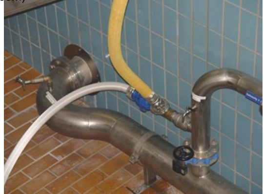
Lufteinspeisung in der Wasseraufbereitungsanlage
