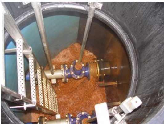
Spülwasserauslass im Quellsammelschacht
