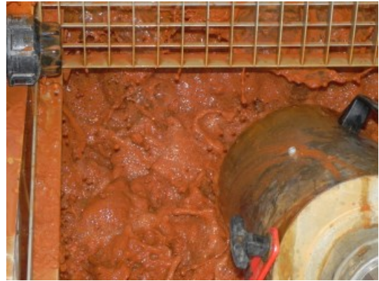
Spülwasserauslass im Hochbehälter (in den Entleerungsschacht)
