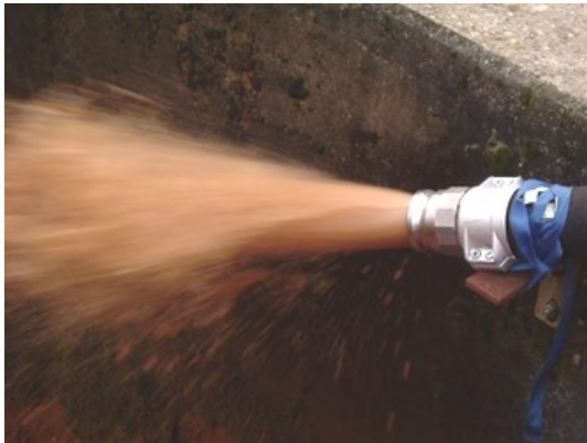
Rohrnetzspülung-Rohwasser: Spülwasserauslass mit einem flexiblen Rohr
